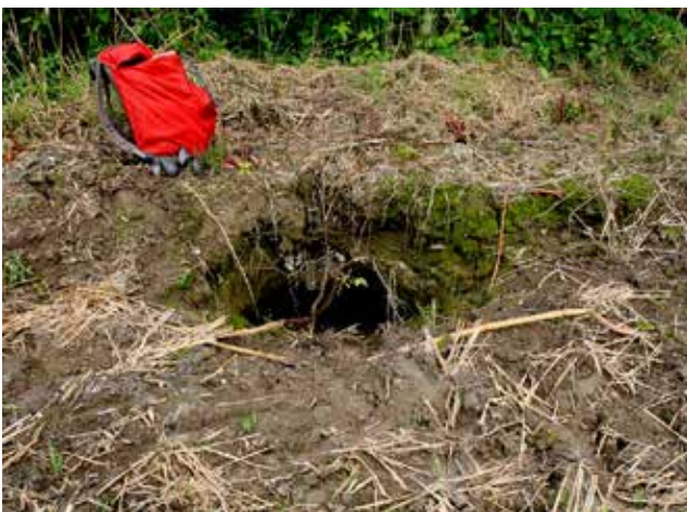
Einbruch am Gewässerufer
